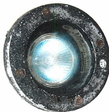
b) korozní napadení rámu / attack of light frame
